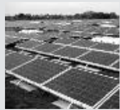
Dachanlage St. Augustin
