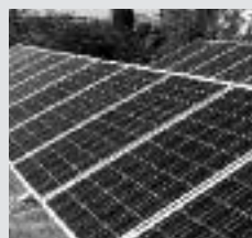
PV-Anlage mit S-Class Ultra Modulen
