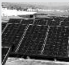
PV-Anlage mit S-Class Excellent Modulen
