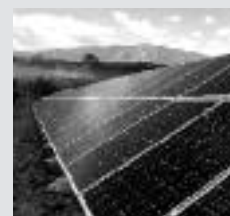
Freilandanlage mit 59 kWp nahe Thessaloniki
